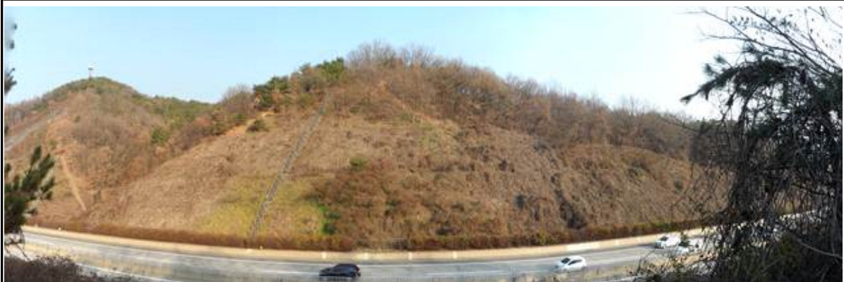
천안절토 19 (순천기점 230.027k~230.410k / STA. 5공구 0k130~0k313)
