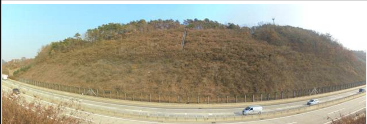
천안절토 17 (순천기점 230.650k~230.940k / STA. 4공구 11k950~11k660)
