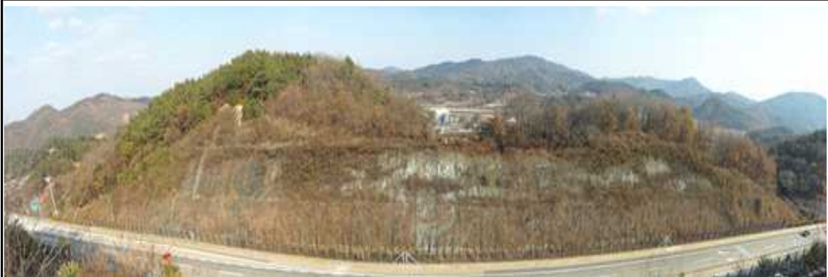
천안절토 16 (순천기점 233.530k~233.913k / STA. 4공구 8k707~9k090)
