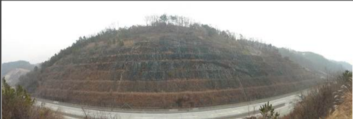
천안절토 21 (순천기점 226.870k~227.280k / STA. 5공구 3k660~3k250)
